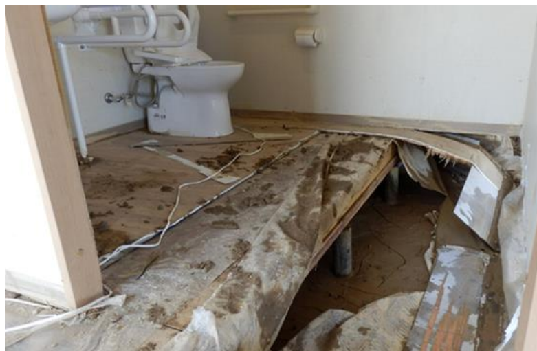
仮設住宅のトイレ（床下は土砂が堆積）
