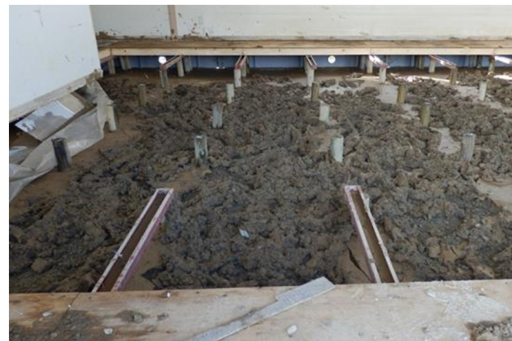
仮設住宅のリビング（床下は土砂が堆積）
