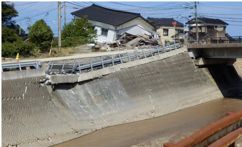
破損した大谷川の法面
